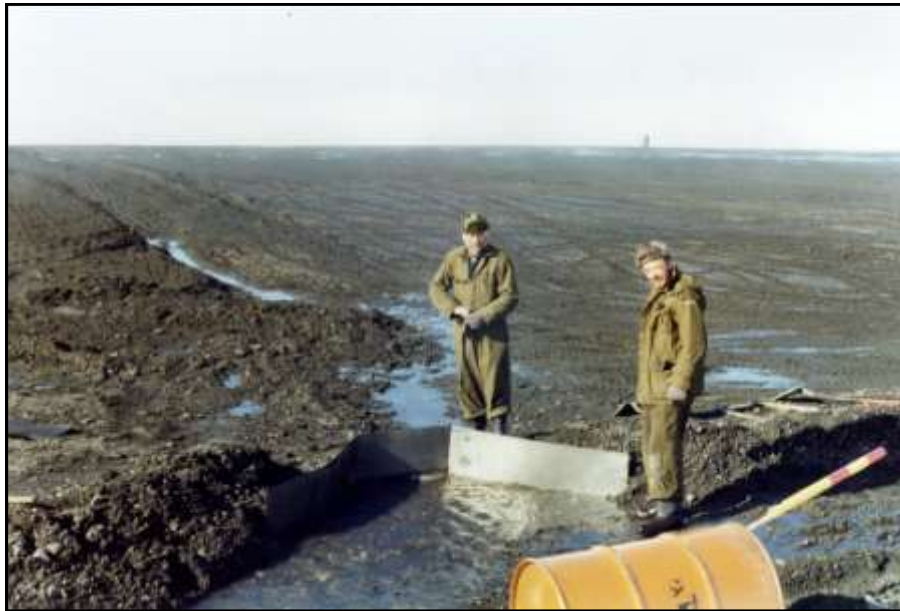
Der måtte lægges rør under banen, så vandet kunne blive ledet væk.
